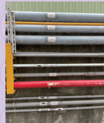
管線整理標示
